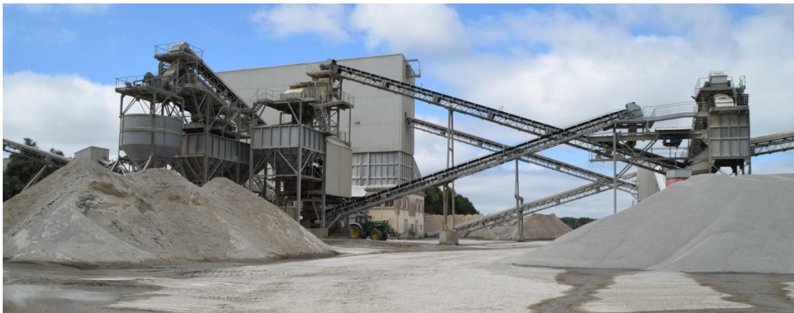
Installations fixes de transformation du site
